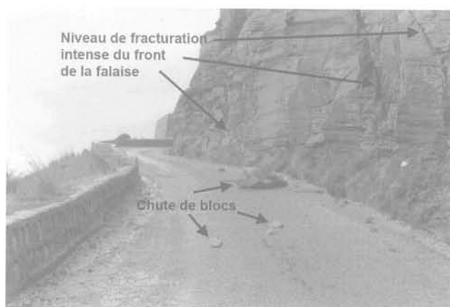
FIG. 3 Chute de blocs de taille variable au niveau de la chaussée en pied de la falaise.
